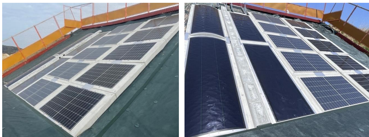
太陽光発電ブロック現地写真
